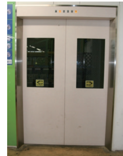
出入口の幅の広いエレベーター
